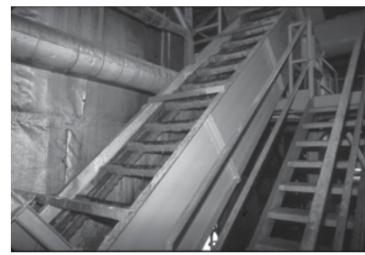
Transportador de bagazo, sección de elevadores/transportador
